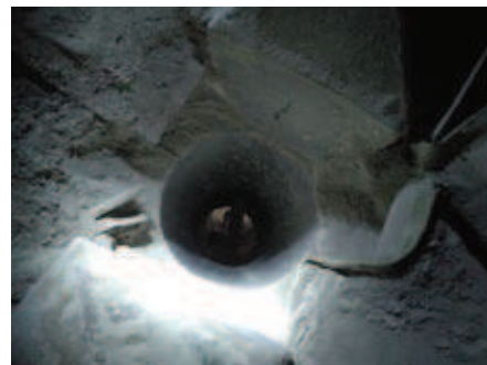
Рис. 1. Остатки груза внутри котла
